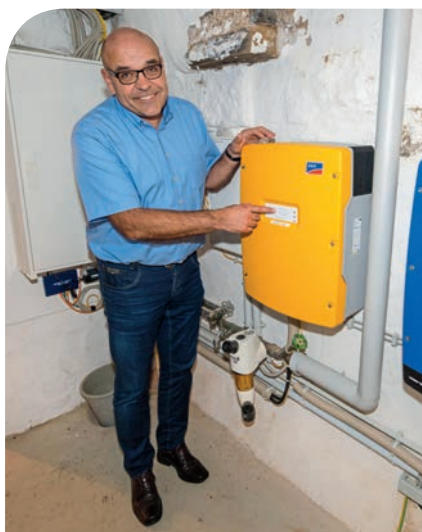
Wolfgang Maier zeigt den Wechselrichter der Batteriespeicheranlage.
