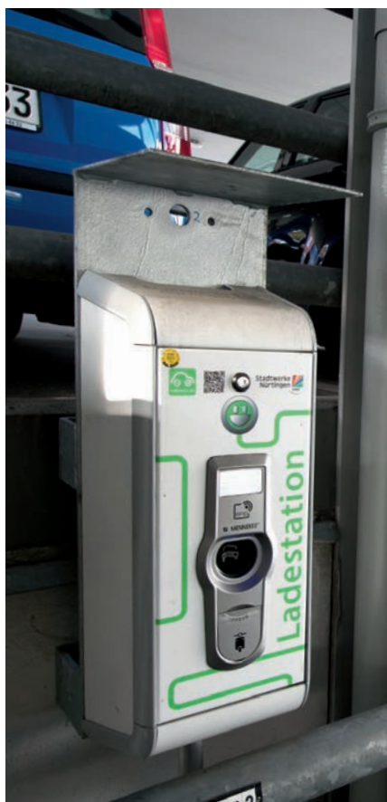
Die Ladesäule im Parkhaus P4 in der Bahnhofstraße.
