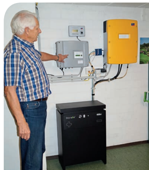
Der Batteriespeicher (unten) ist nicht größer als ein Kühlschrank.
