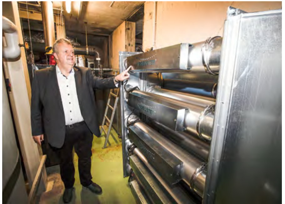
Volkmar Klaußer, Geschäftsführer der Stadtwerke Nürtingen GmbH, im Keller des Inselbades Zizishausen vor der UV-Anlage
