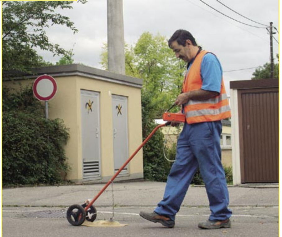
Mit einem Messgerät spürt Yasar Celik Lecks in Gasleitungen auf.
